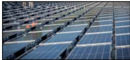
© CAM | Instalación fotovoltaica
